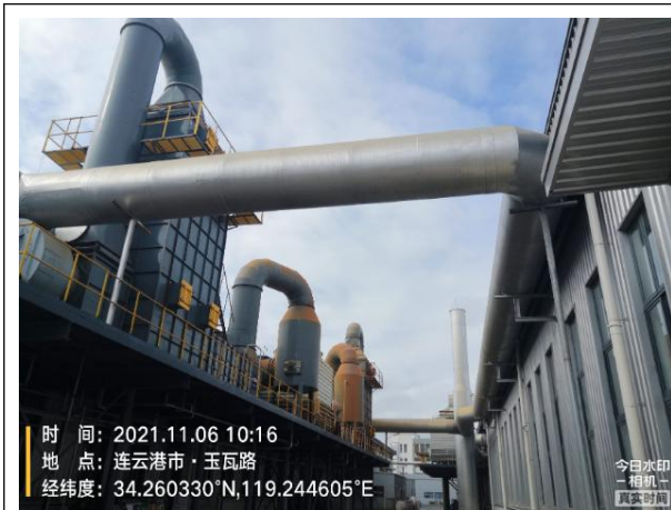
排气筒 DA014 及油烟处理设施
