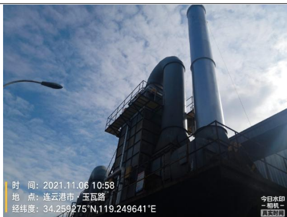
排气筒 DA006 及油烟处理设施
