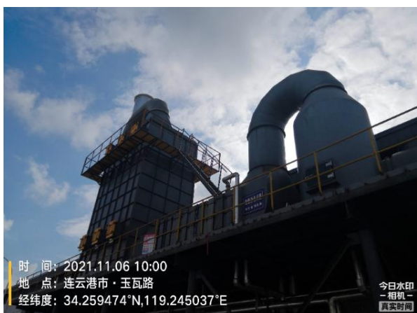
排气筒 DA013 及油烟处理设施
