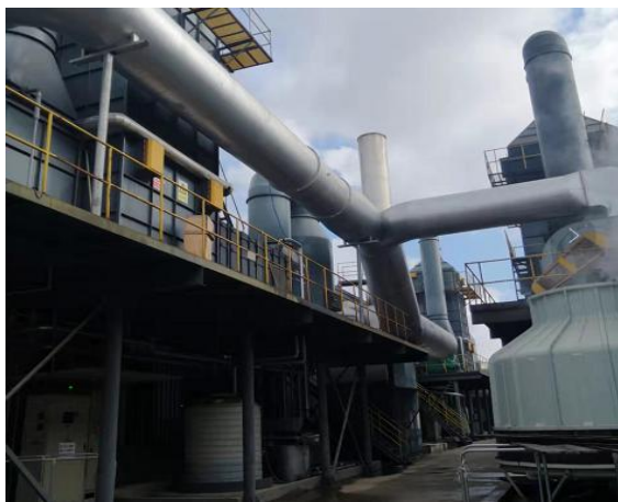
排气筒 DA003 及油烟处理设施
