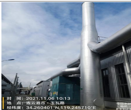
排气筒 DA015 及油烟处理设施
