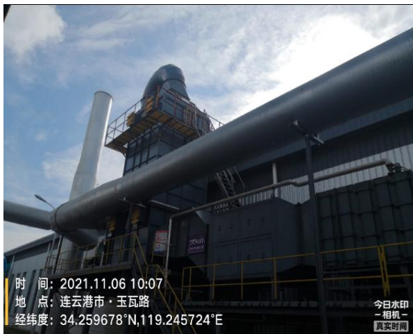
排气筒 DA012 及油烟处理设施
