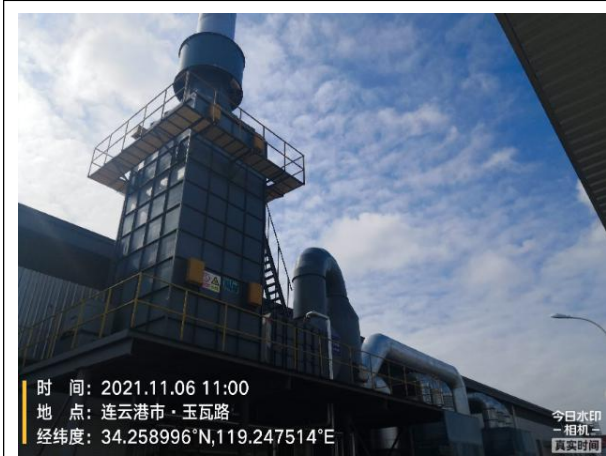
排气筒 DA005 及油烟处理设施
