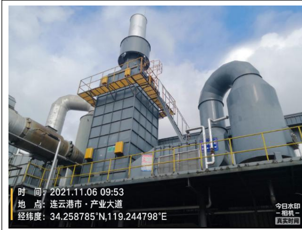
排气筒 DA002 及油烟处理设施
