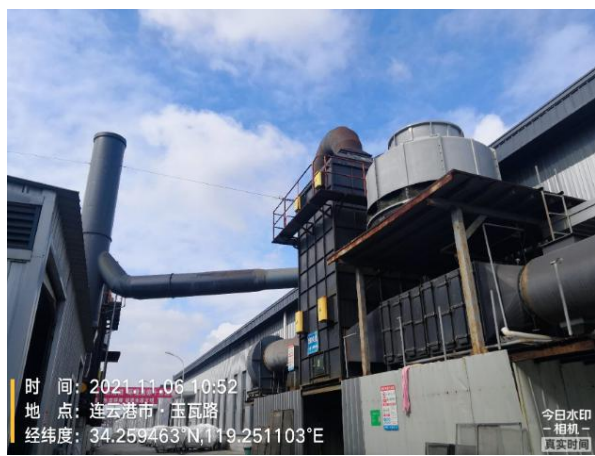
排气筒 DA007 及油烟处理设施
