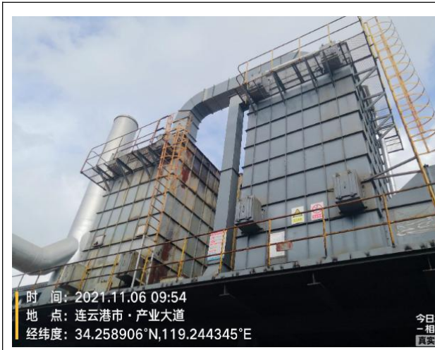
排气筒 DA001 及油烟处理设施
