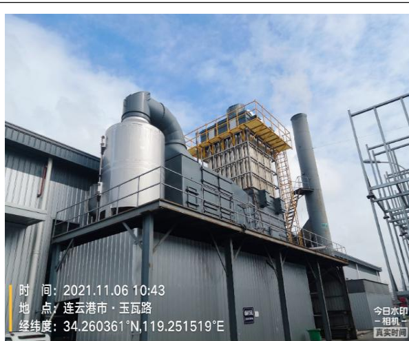
排气筒 DA010 及油烟处理设施
