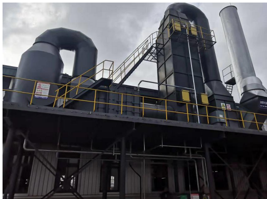
排气筒 DA004 及油烟处理设施
